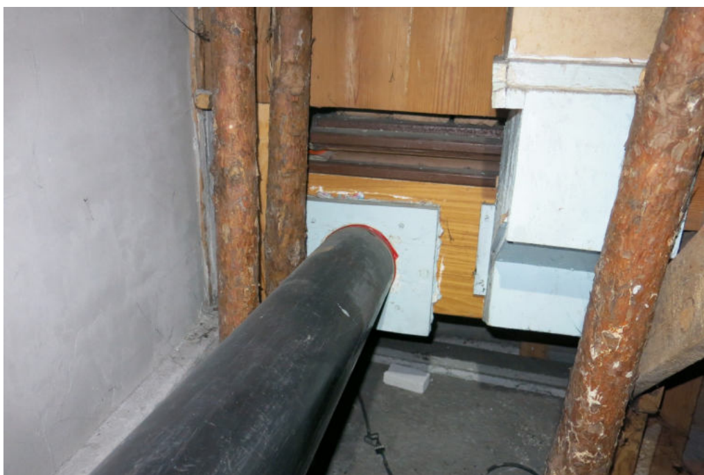
Rura pcv jako kanał powietrzny. Pozostałości po rusztowaniach.
